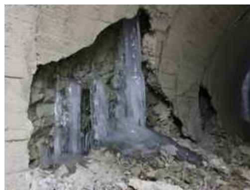
写真7-1B 覆工（巻立）コンクリート側壁部崩落箇所。第3・4号内巻区間の間。写真右側奥に第3号内巻の米沢側端部が僅かに見える（昭和28年〔1953年〕補修箇所）。崩壊箇所は、昭和9年〔1934年〕施工箇所。米沢側から望む。
