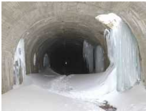
写真 8 —4A 米沢側坑口開口部手前から福島側を望む。 手前覆工崩落箇所(開口部)氷柱群(写真 8 —2C)参照。
