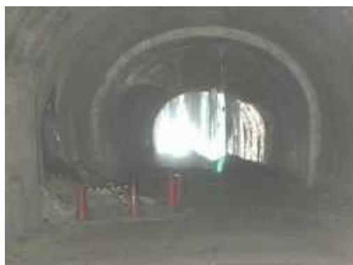
写真7-1A 第3号・第4号内巻間の右側（福島側から見て）側壁崩壊が進行する。第3号内巻区間の米沢側の端部が見える。米沢側から望む。darkさん提供（以下同）
