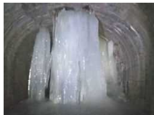
写真5-10 巨大氷柱群、福島側から望む。 中央氷柱、下幅2.7m(実測)。
